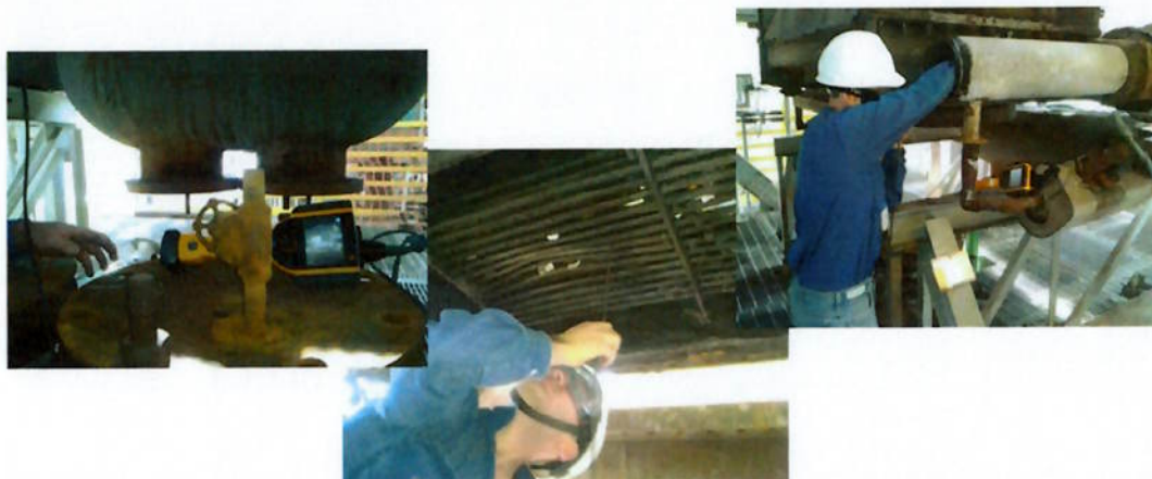
Figura 35: Avaliação por videoscopia dos tubos do TLE após o hidrojateamento
